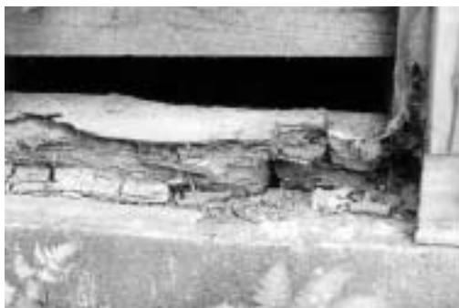
写真1 土台の腐朽例
