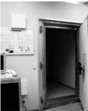
写真1 磁気シールドルーム
