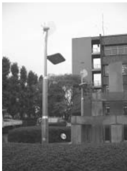
写真2 正面玄関前に設置された小型風力・太陽光発電装置
