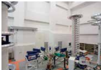
高電圧実験室
