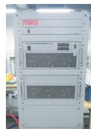
直流大電流電源装置
