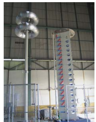
導入する高電圧機器
