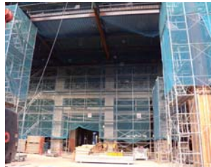
図3 エントランス廻り
